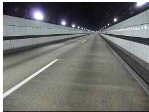
《蛍光灯照明》 関越道 関越トンネル
