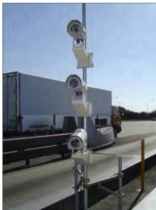
(不正通行対策用監視カメラ)
