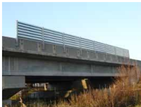
(防雪柵設置状況) 道央道 江別東IC～岩見沢IC間
