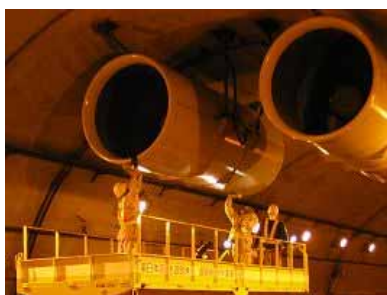
(トンネル換気設備の点検) 富津館山道路 鋸山トンネル
